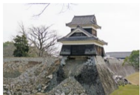
石垣が崩れ、中が剥き出しになっている「戌亥櫓」。大きな石の中にはうらごめ石といった小さい石が詰められていることがわかります。
