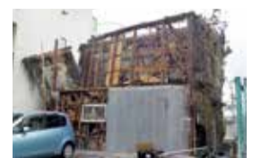
倒壊の危険性がある、今回除却する神戸市中央区熊内橋通5丁目の建物。
