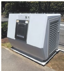
芦屋市内にあるパイプラインの投入口の1つ。
